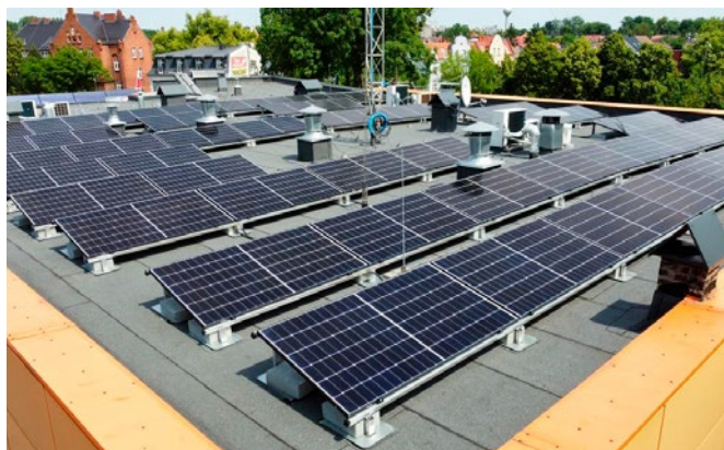
Fot. 1. Instalacja fotowoltaiczna wykonana na dachu budynku
