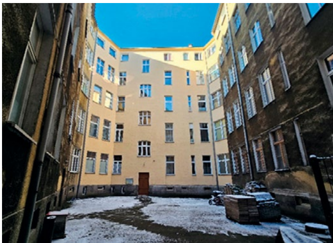
Fot. 1C. Widok ścian zewnętrznych od strony oficyny części kamienicy przyległej do ul. Monte Cassino, na których zastosowano dodatkowe powłoki malarskie mające spełniać rolę izolacji termicznej
