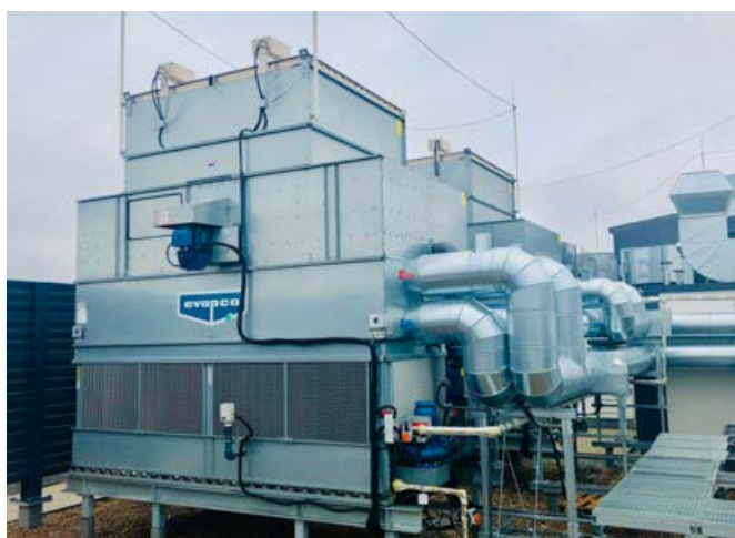
Wieże chłodnicze na dachu budynku
