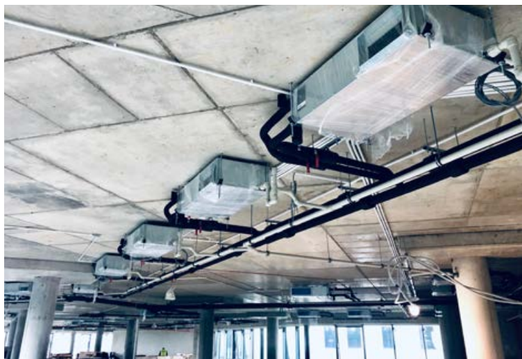
Pompy ciepła w części biurowej
