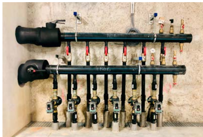
Jeden z 14 rozdzielaczy zlokalizowanych na poziomie garaży
