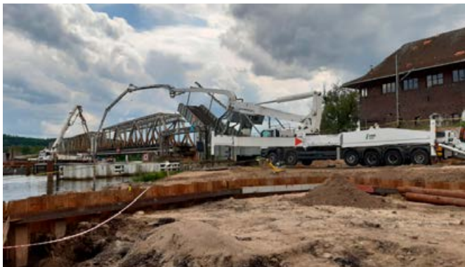
Fot. 7. Betonowanie pali przy użyciu dwóch połączonych pomp do tłoczenia masy betonowej o wysięgach 70 m i 42 m
