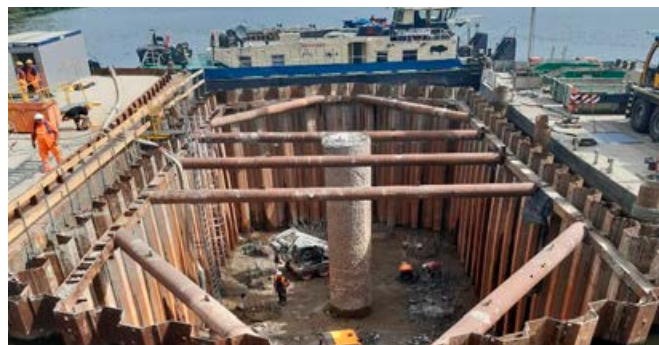
Fot. 11. Rozkucie głowic pali na podporze 3F z wykonaniem warstwy wyrównawczej z betonu niekonstrukcyjnego do rzędnej -7,5 m
