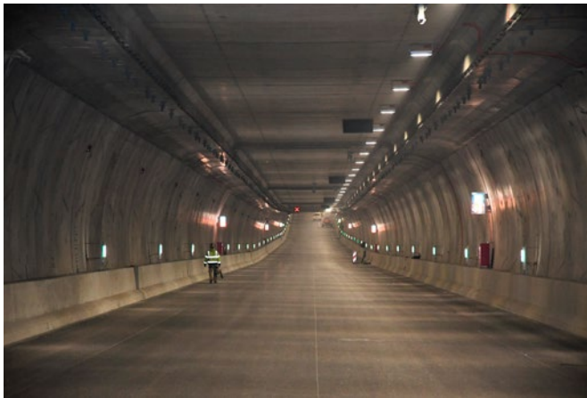
W samym tunelu zainstalowanych jest 110 różnych kamer, a wraz z drogami dojazdowymi po obu stronach – 143
