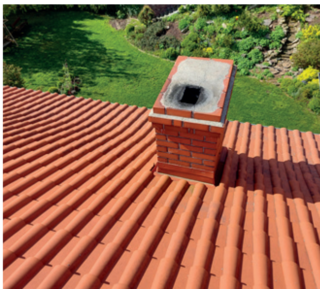
Brak komunikacji do przewodu dymowego, zgodnie z przepisami konserwacja raz na trzy miesiące w okresie użytkowania
