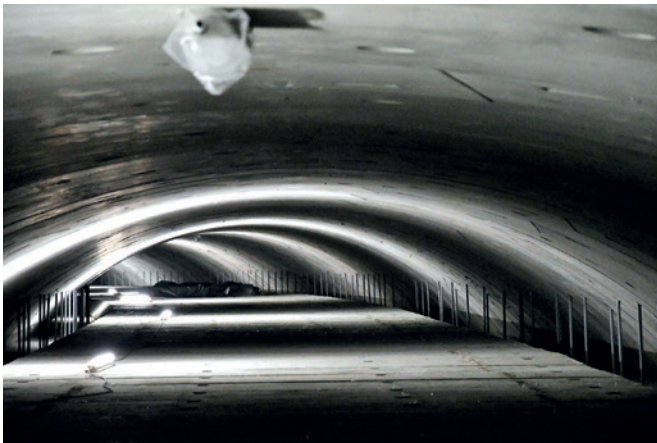
Kanał technologiczny biegnący pomiędzy sufitem a obudową tunelu
