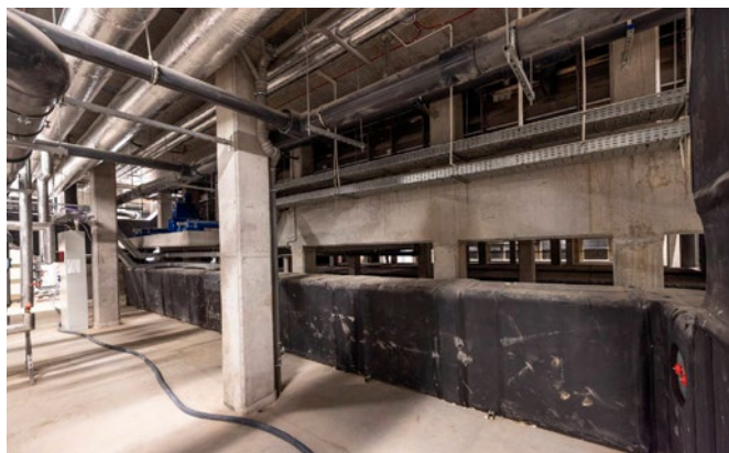
Instalacje technologii wody basenowej
