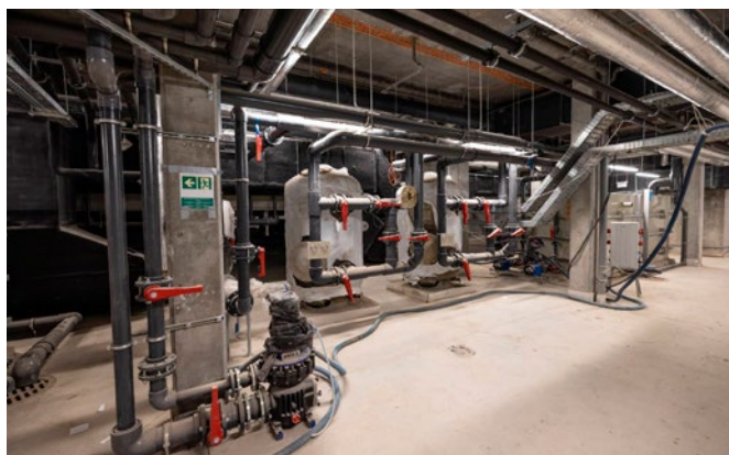
Instalacje technologii wody basenowej
