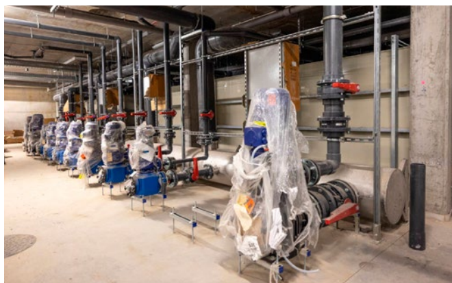
Instalacje technologii wody basenowej
