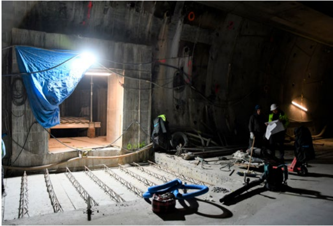
Jedno z wyjść ewakuacyjnych, które powstało poza obudową tunelu
