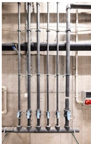
Instalacje technologii wody basenowej
